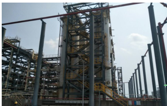
▲ 公司槽區管線配置情形
