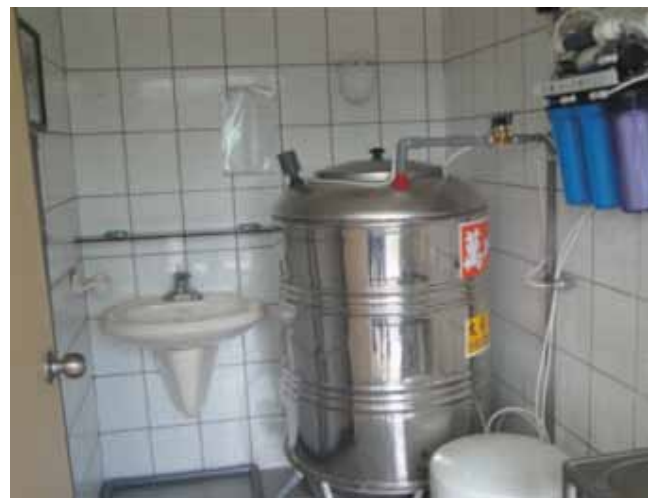
■ RO 逆滲透加裝回收水再利用系統。
