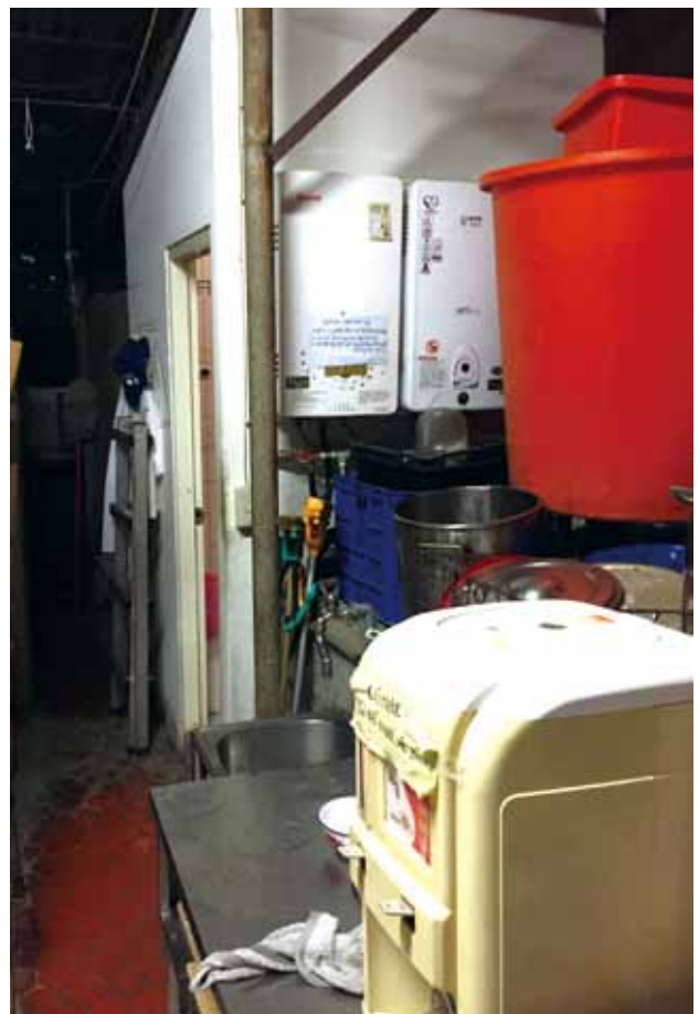
■熱水器未裝設於建築物外牆，或裝設於有效開口且與戶外空氣流通的位置，以及未裝設熱水器排氣管將廢氣排至戶外，就有可能發生一氧化碳中毒事件。
